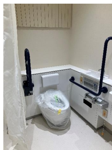
くるま 車いす使用者用 しょうしや トイレ
